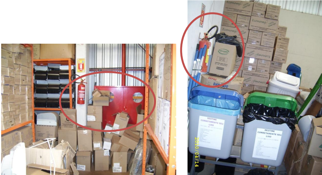
Figura 18: Obstrução de equipamentos de segurança
