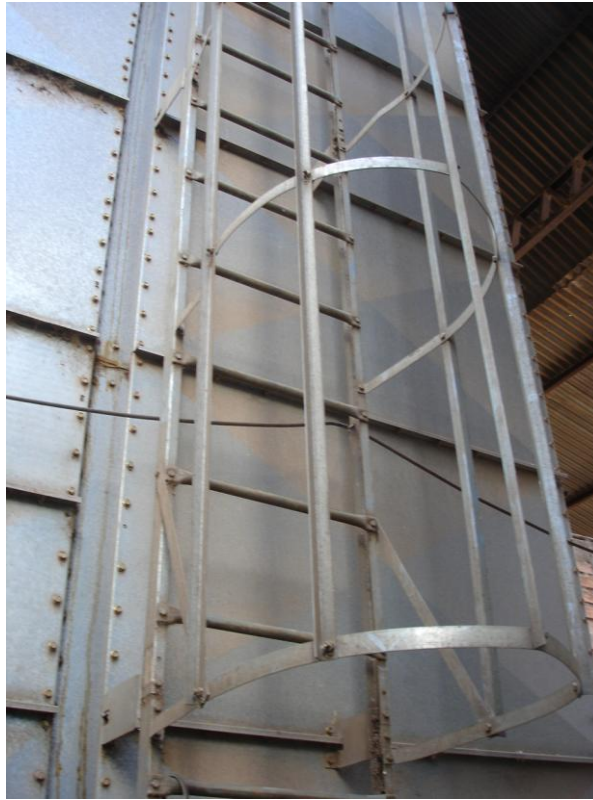
Figura 15: Anéis de proteção de escadas
