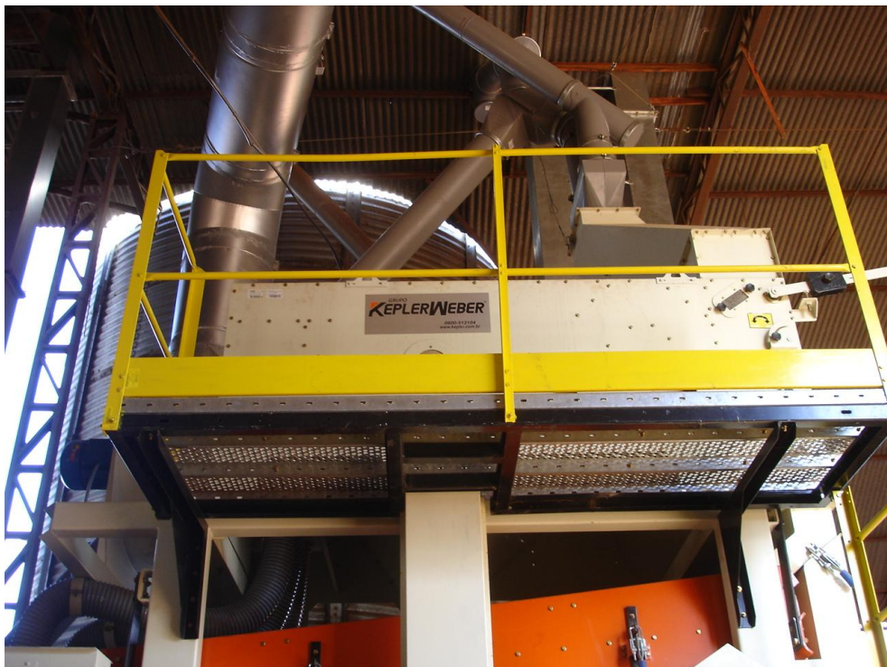
Figura 14: Barras de proteção
