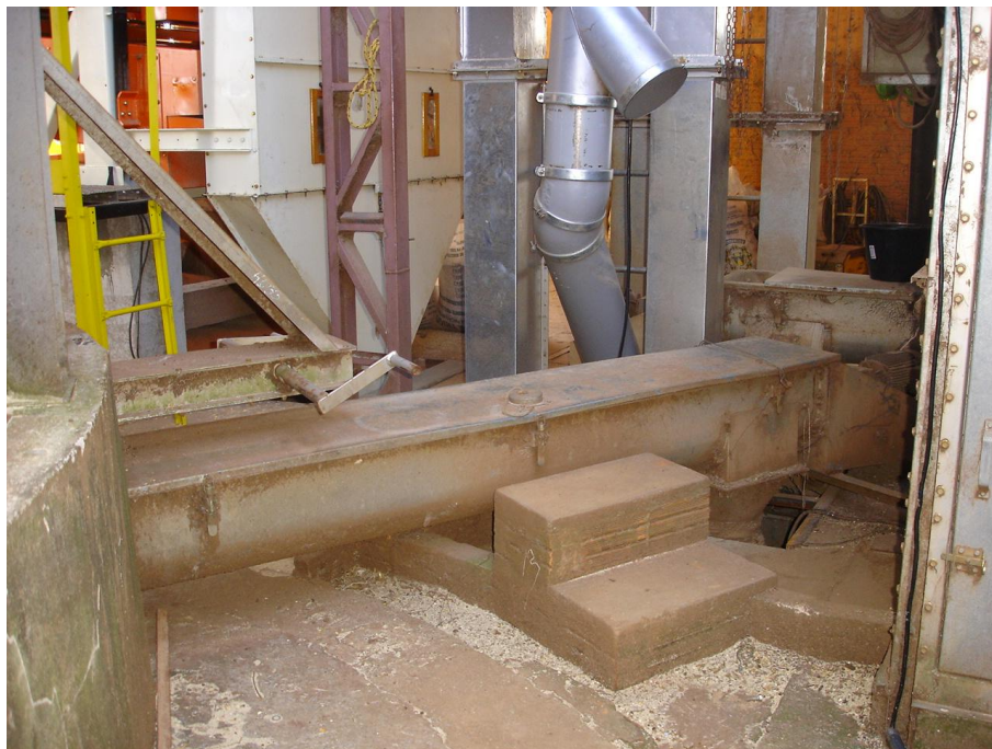
Figura 13: Passagem sobre tubos de transporte
