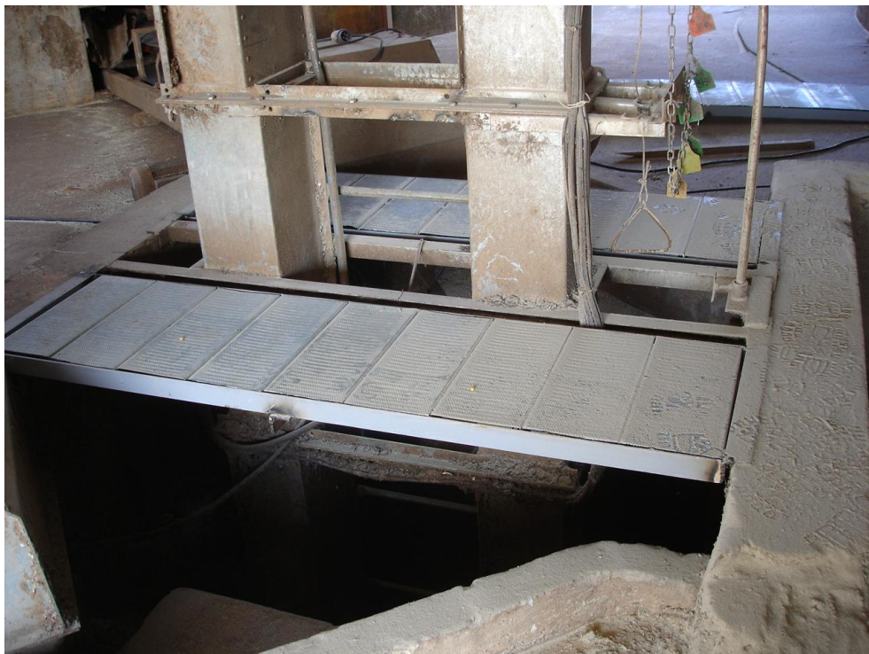
Figura 16: Barras para proteção dos poços de elevadores
