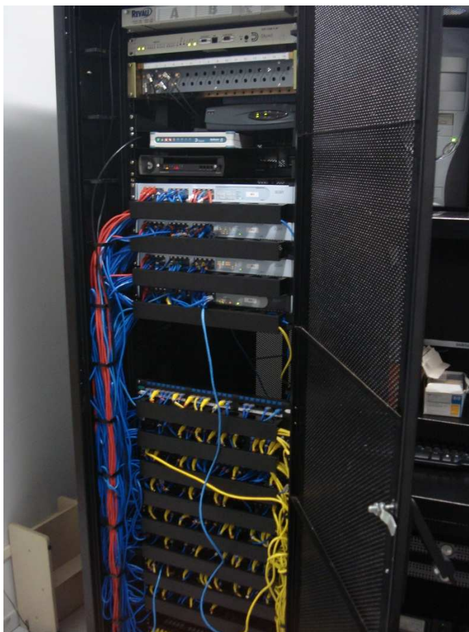
Figura 4: Rack de distribuição saturado
