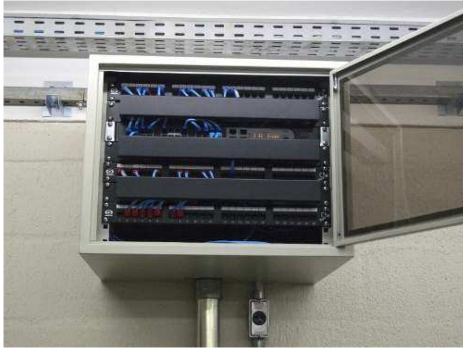
Figura 7: Pequenos racks para instalação e distribuição dos links de fibra ótica
