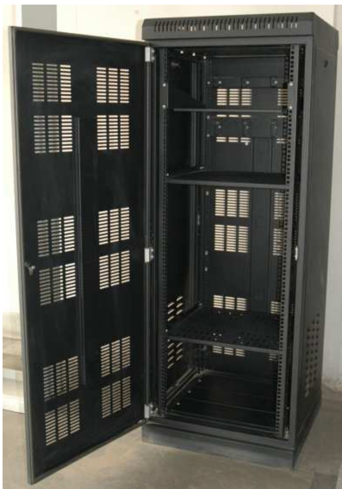
Figura 6: Novo rack para futuras instalações
