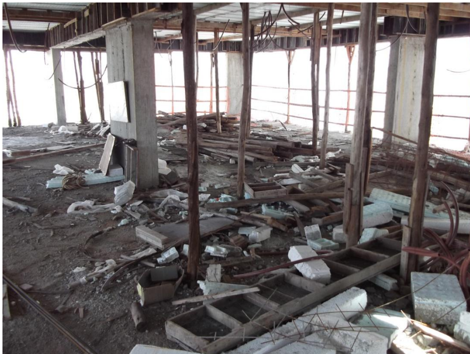
Figura 9: Pavimento sem realização de limpeza no Canteiro B.
