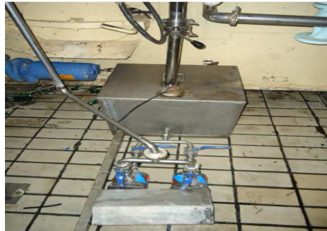
Figura 32 - Bomba água recuperada para torres.
