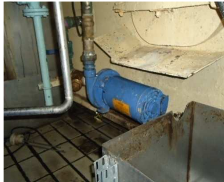
Figura 31 - Bomba água recuperada para banheiros.
