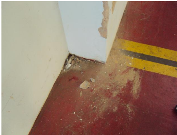
Falta de cuidados na movimentação dos materiais
