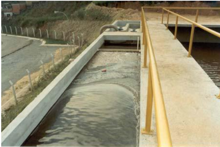
Figura 4: Caixa separadora de óleo/gordura instalada em uma indústria de bebidas. Fonte: Giordano (1999).
