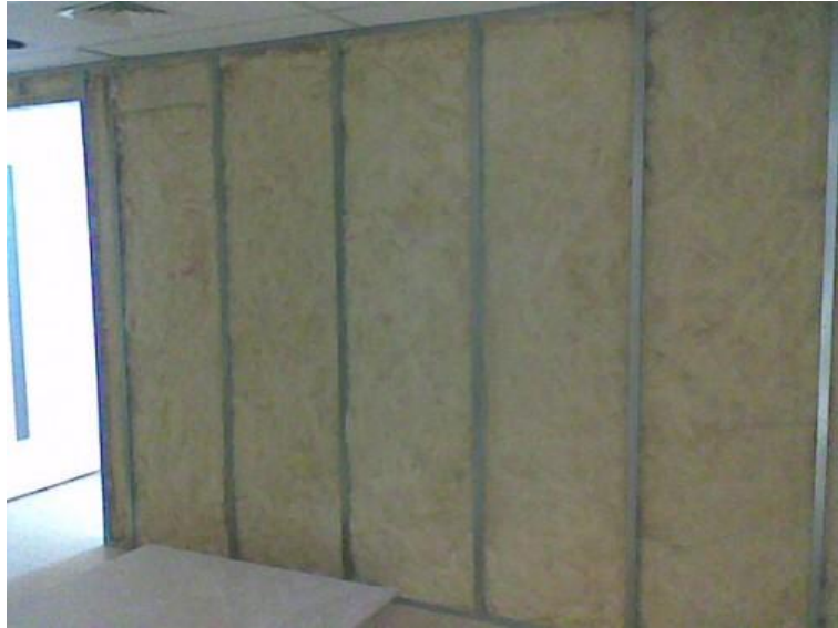
Figura 22: Parede com manta de lã mineral para isolamento
