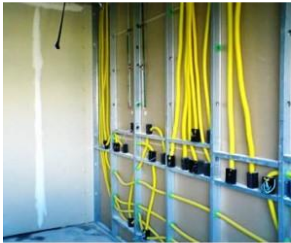
Figura 32: Instalações elétricas no interior da parede de gesso acartonado
