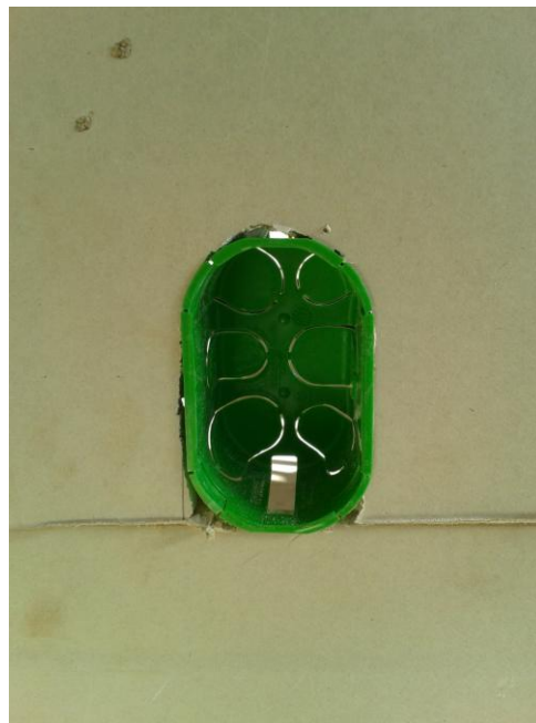
Figura 24: Instalação elétrica sem os devidos cuidados
