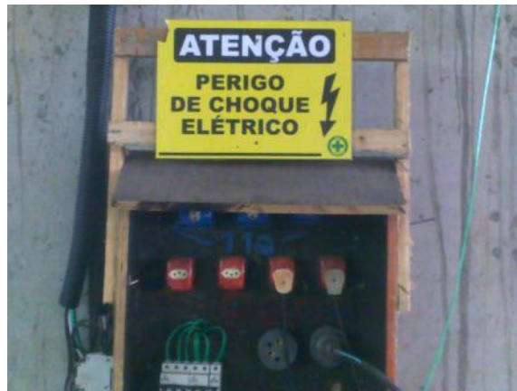
Figura 27 - Aviso Perigo de Choque
