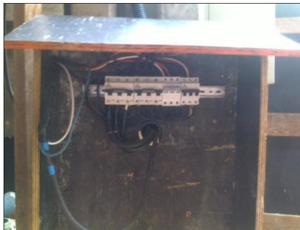
Figura 28 - Instalação Elétrica Coberta
