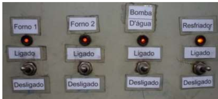
Figura 6 - Painel de Controle dos Fornos
