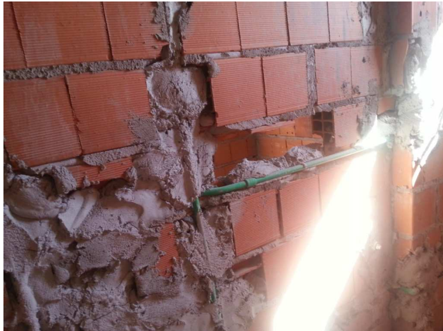
Figura 20-Erro na execução da alvenaria 01
