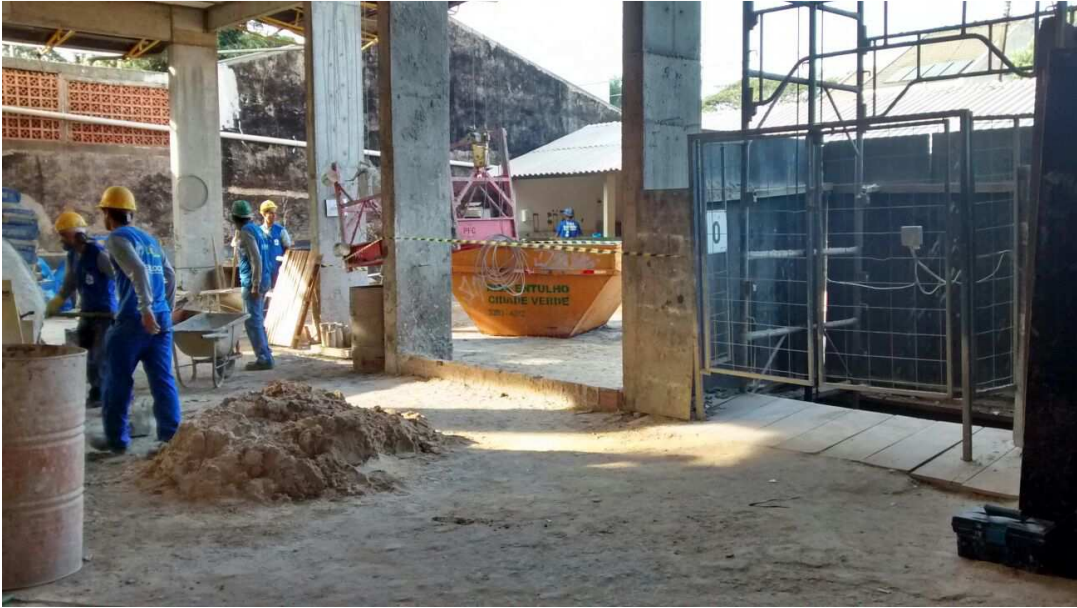
Figura 12-Caçamba para despejo de resíduos Fonte: Autor
