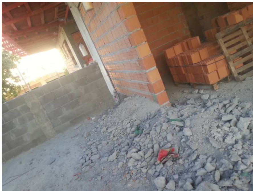
Figura 36- Desperdícios 03 na Obra Fonte: Autor
