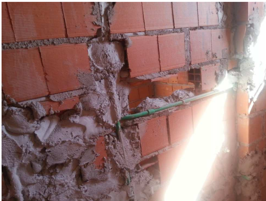
Figura 35-Desperdícios 02 na Obra Fonte: Autor
