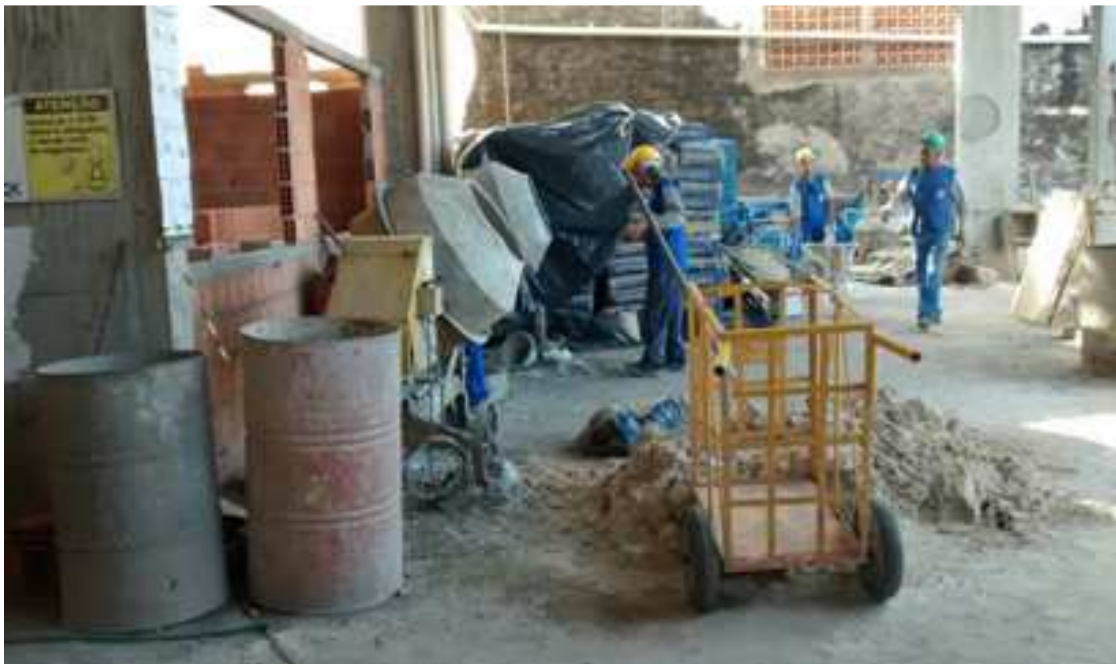
Figura 28- Local das betoneiras e desperdício de areia Fonte: Autor
