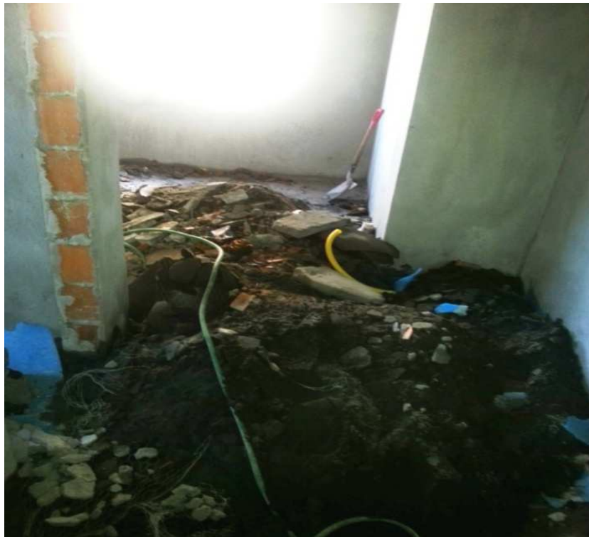
Figura 22-Desperdícios na obra 02 Fonte: Autor
