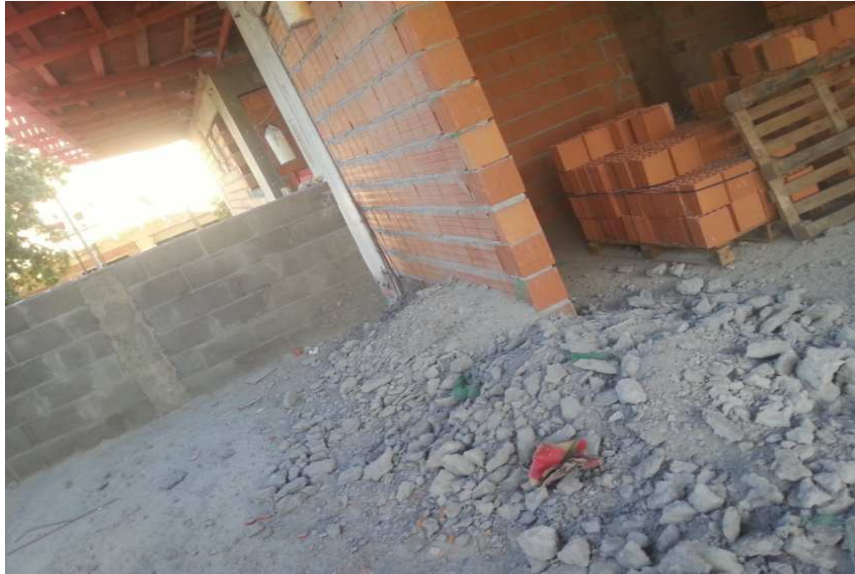
Figura 21-Erro na execução da alvenaria 02 Fonte: Autor
