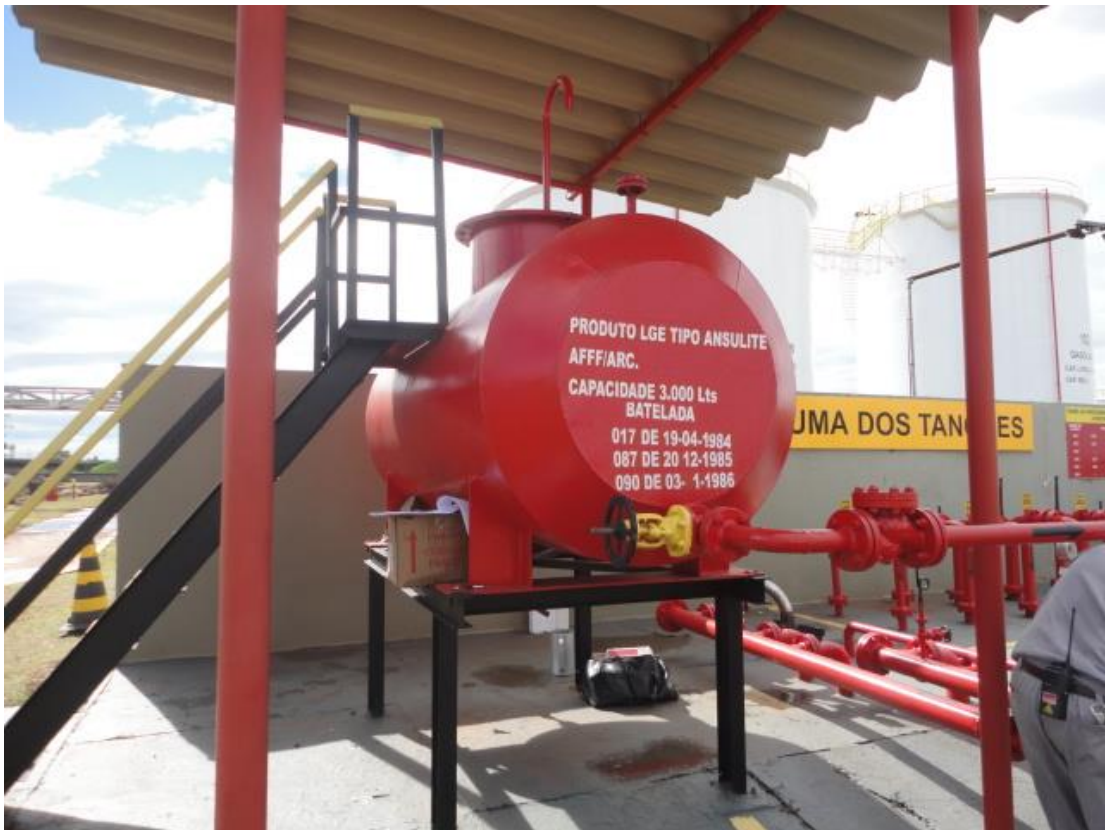
Figura 7: Tanque de abastecimento de LGE.
