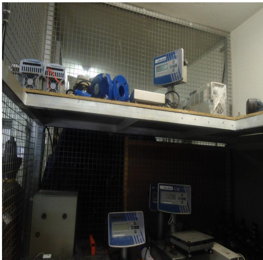
Figura 11 - Sala de Máquinas antes dia D
