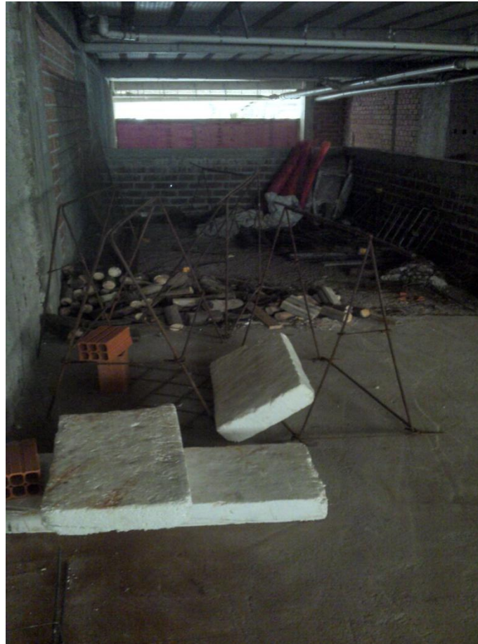
Figura 24: Falta de organização geral da obra.
