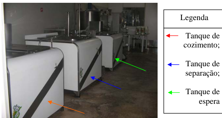
Figura 6. Tanque de cozimento, tanque de separação e tanque de espera
