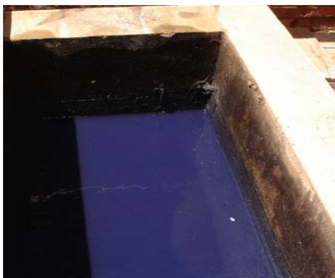
Figura 14 – Caixa de separação Fonte: Primária
