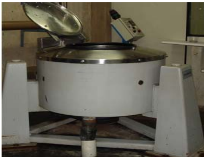
Figura 10 – Foto da máquina para centrifugar - Lavanderia Fonte: Primária
