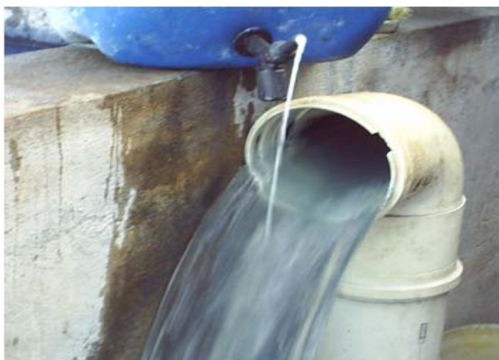
Figura 19 – Despejo na rede de esgoto Fonte: Primária
