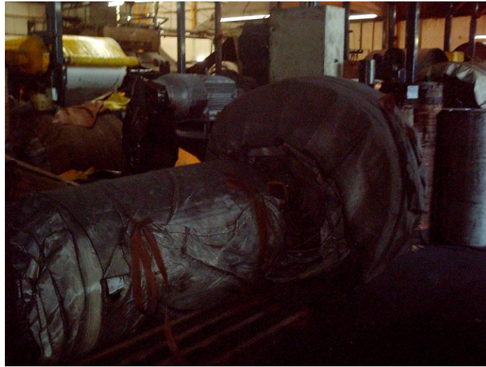
Figura 8: Rolos Calandrados setor 4.
