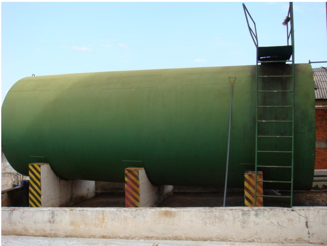
Figura 8: Tanque de Armazenamento de sebo
