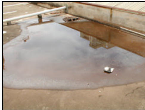
Figura 18 - Abaulamento da laje. Fonte: Carla F. Marek, (2000).
