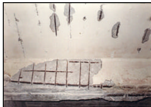
Figura 17 - Desplacamento do concreto Fonte: Jefferson Maia Lima, (2000).
