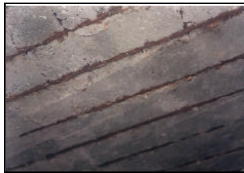
Figura 04 - Corrosão generalizada e expansão da seção das armaduras na laje. Fonte: José R. S. Pacha, (2000).
