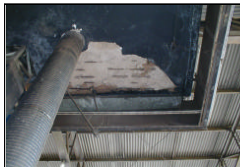
Figura 05 - Armadura aparente. Fonte: Carla F. Marek, (2003).
