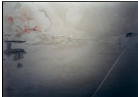
Figura 10 - Corrosão nas armaduras, lixiviação do concreto provocado pela água. Fonte: Jefferson Maia Lima, (2000).
