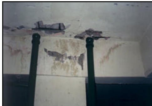
Figura 09 - Corrosão nas armaduras e infiltrações próximas as tubulações. Fonte: Jefferson Maia Lima, (2000).
