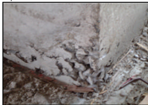
Figura 20 - Exemplo típico de nichos de concreto. Fonte: Carla F. Marek (2005).
