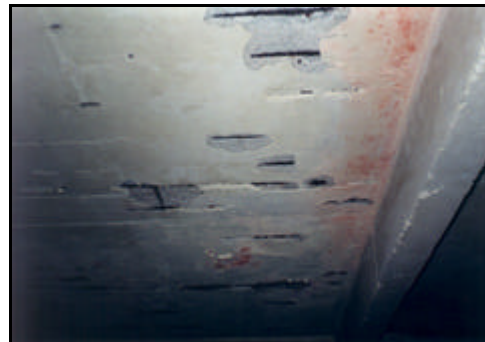
Figura 16 - Descolamento do concreto. Fonte: Jefferson Maia Lima, (2000).
