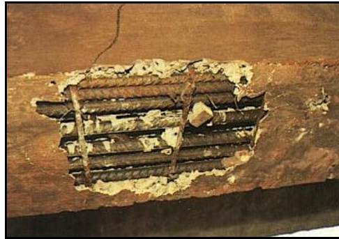
Figura 12 - Nicho de concretagem na viga, originalmente encoberto por concreto que não penetrou entre a fôrma e as armaduras. Fonte: Revista Técnica nº 8, (2000).
