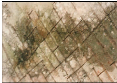
Figura 08 - Infiltração e presença de limo causado pela fissuração. Fonte: Paulo Barroso Engenharia LTDA.
