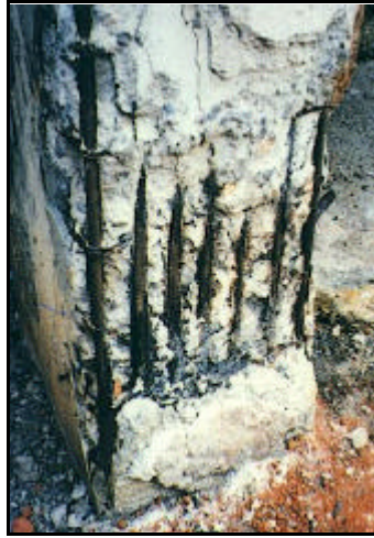
Figura 14- Pilar apresentando desagregação na sua base e conseqüentemente corrosão acentuada.
