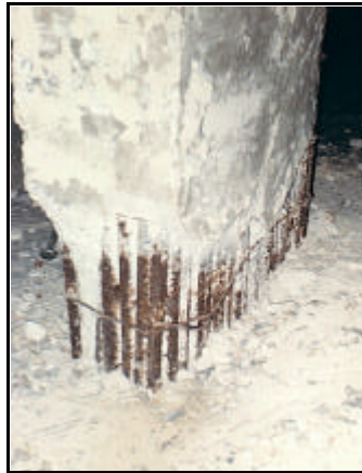
Figura 03 - Corrosão generalizada. Fonte: Jefferson Maia Lima, (2000).
