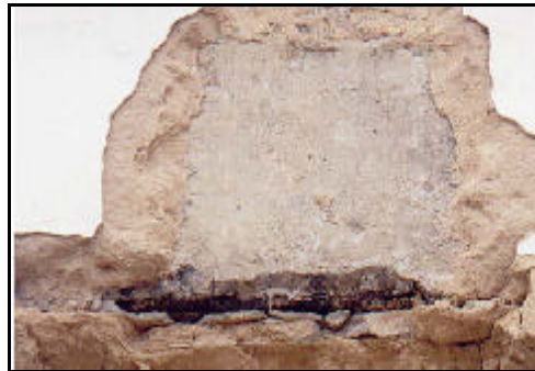
Figura 06 - Cobrimento da armadura inadequado Fonte: http://www.biblioteca.sebrae.com.br
