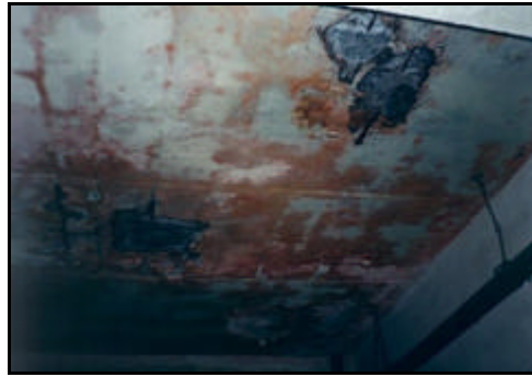
Figura 07 - Corrosão e expansão da seção das armaduras Fonte: Jefferson Maia Lima, (2000).
