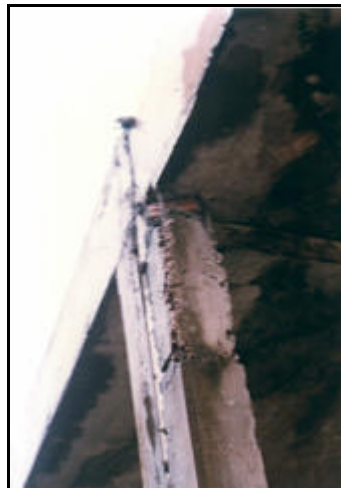
Figura 11 - Nichos de concretagem no encontro do pilar com a viga, posteriormente preenchida com tijolo cerâmico. Fonte: José R. S. Pacha, (2000).
