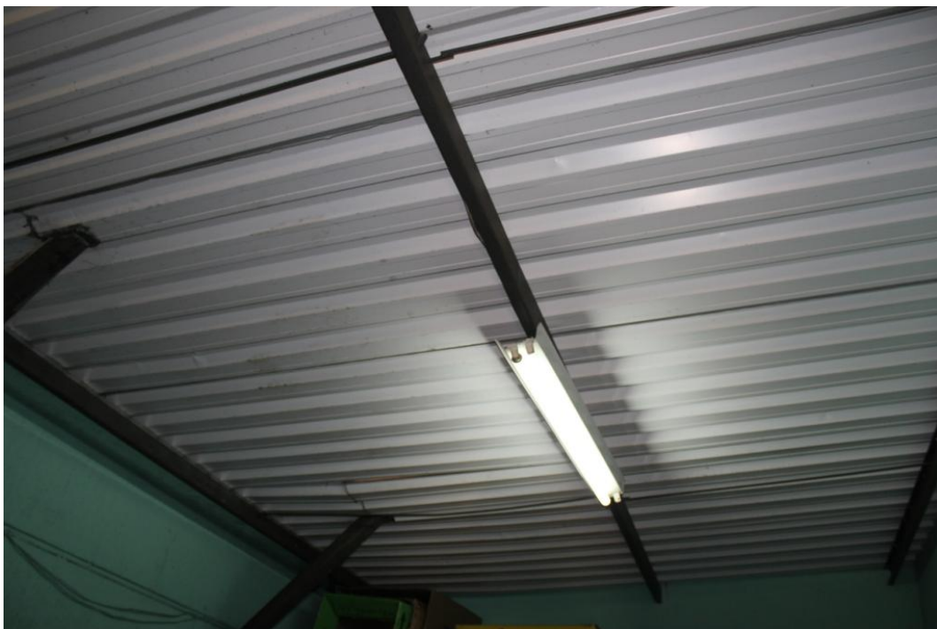
Figura 22: Depósito sem exaustor
