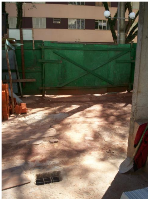
Figura 5: Furo na rampa para empurrar areia para o subsolo
