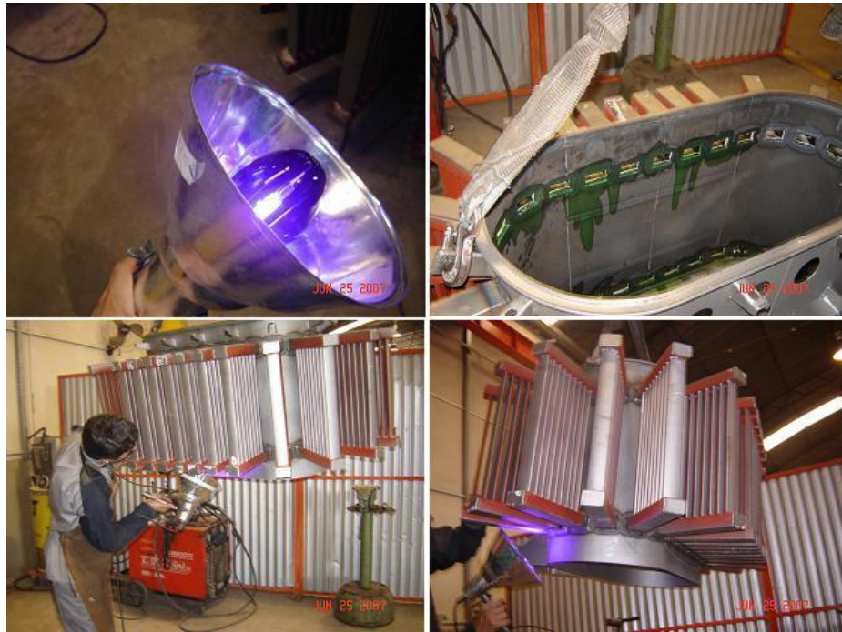
Figura 17: Teste de estanqueidade.
