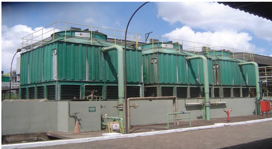
Figura 3: Torre de Resfriamento I
