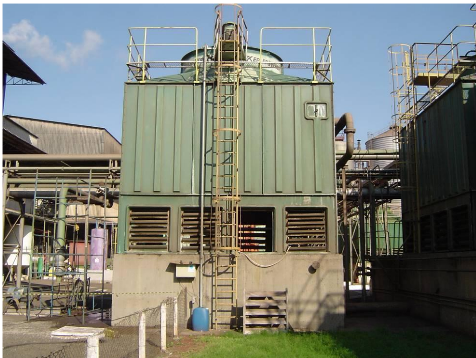
Figura 4: Torre de Resfriamento II
