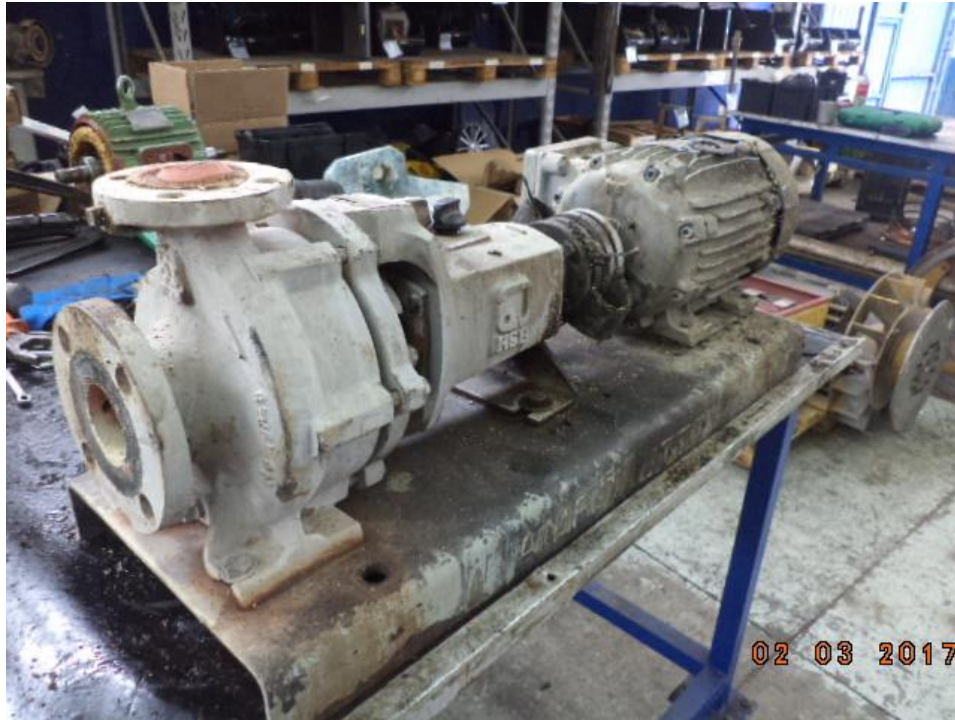
Figura 17: Equipamento antes do serviço de manutenção.
