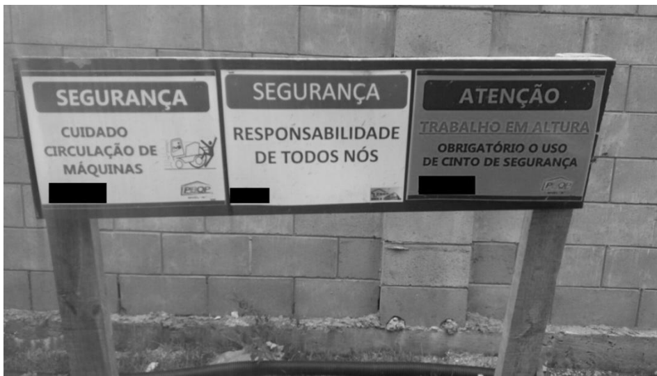
Figura 11 – Sinalizações de Segurança existentes no Canteiro de Obras 2
