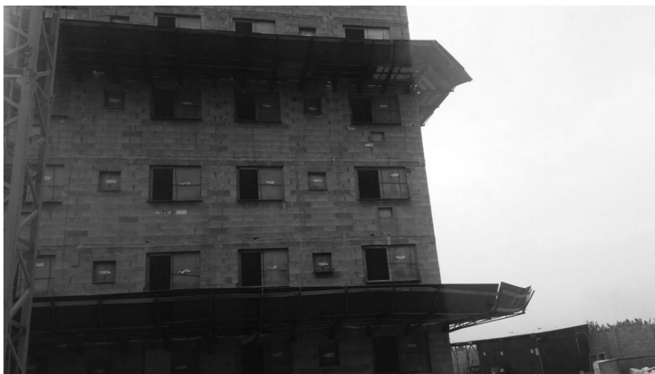
Figura 09 – Plataformas de proteção principal e secundária no Canteiro de Obras 2
