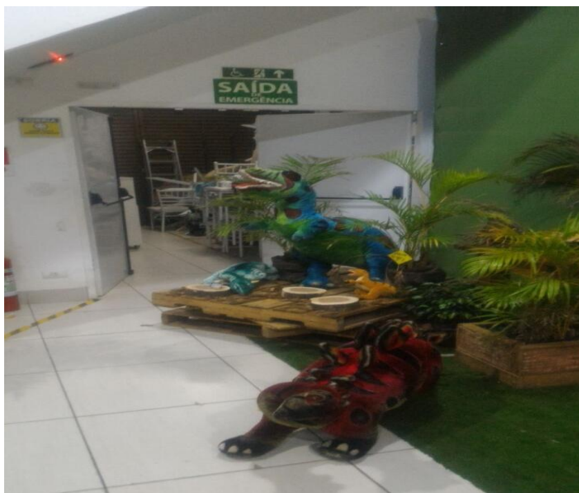
Figura 14 - Obstrução da saída de emergência
