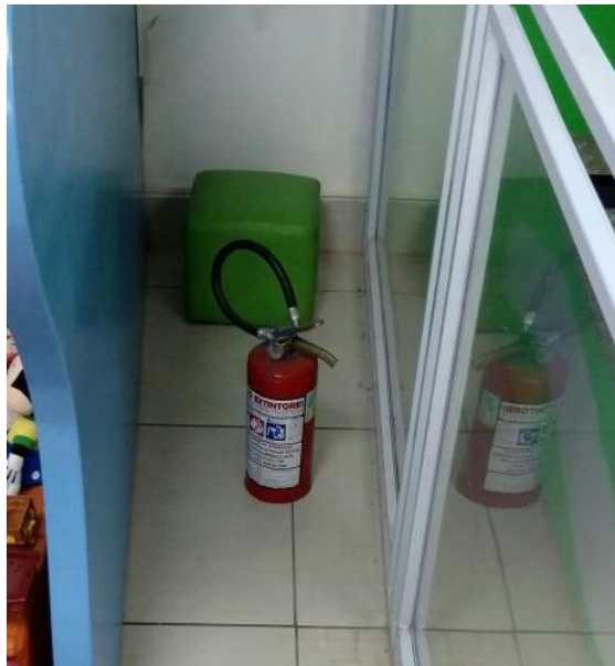
Figura 13 - Extintor alocado no chão
