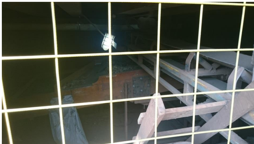
Figura 11 - Catadora de pedras, localizada no subsolo, abaixo da moega.
