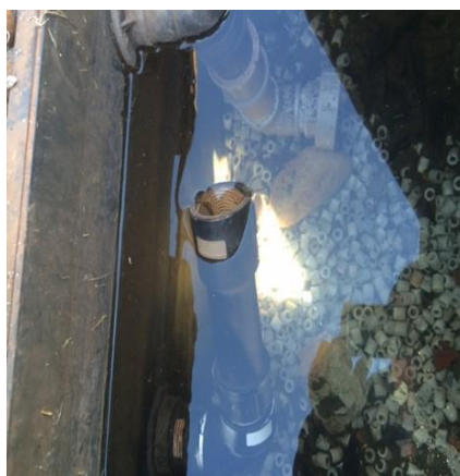
Figura 3 – Encanamento que proporcionava desperdício de água, quando usado em posição errada
