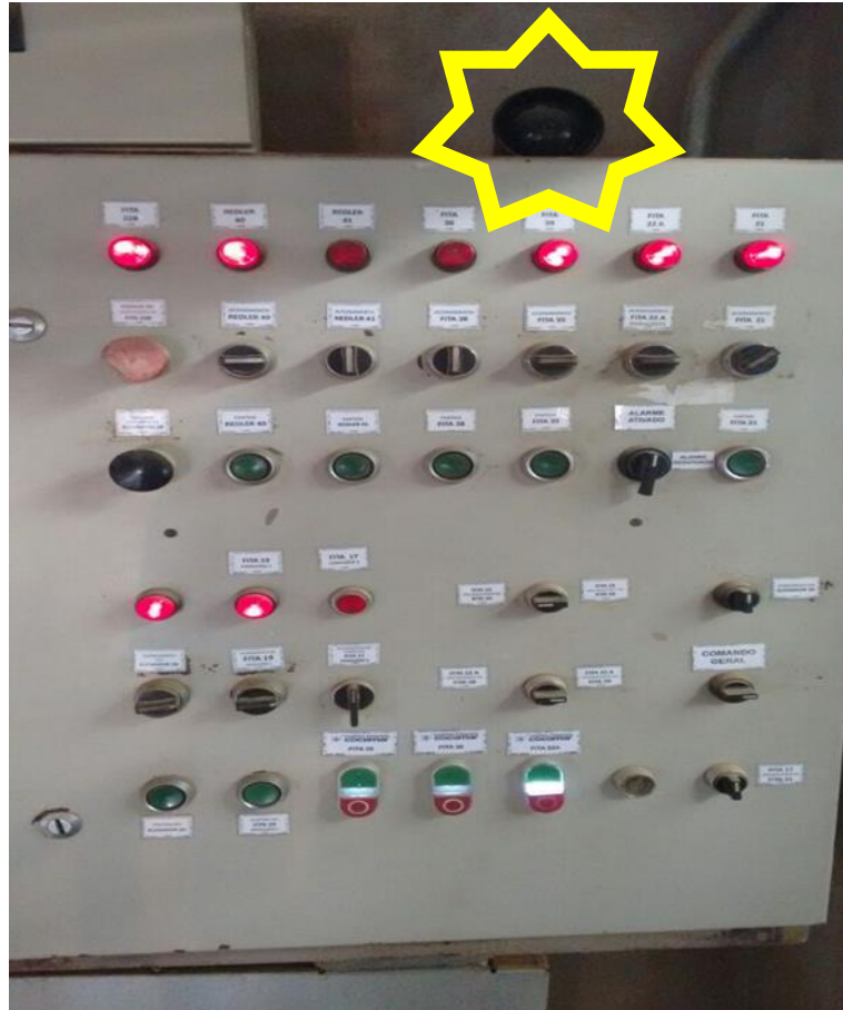
Figura 33 - Alarme sonoro desarme das fitas transportadoras. Fonte: Empresa concedente.
